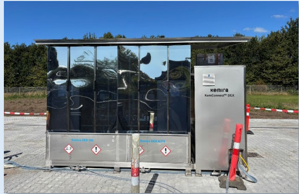
Hygiejniseringsanlægget under indkøring.
